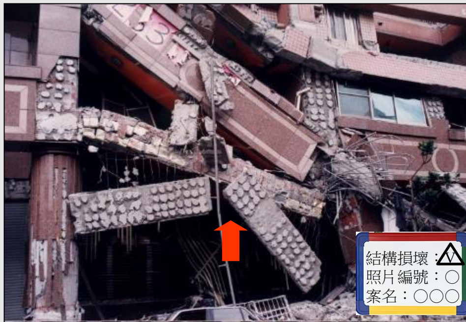
梁斷裂，鋼筋挫曲，樓層崩塌下陷
