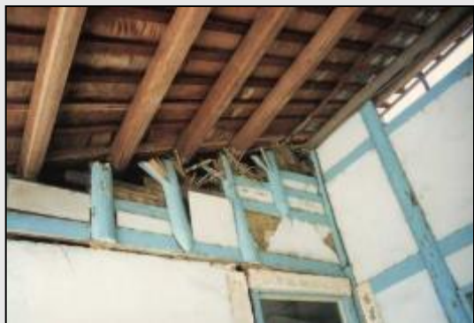
竹泥造房子屋頂樑支撐移位
