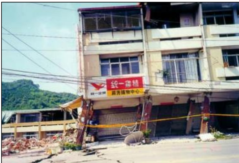
沿騎樓方向傾倒
