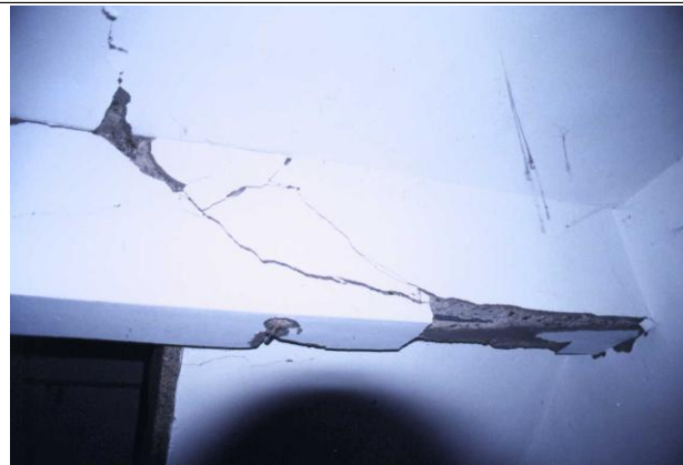
照片 P4：梁裂損
