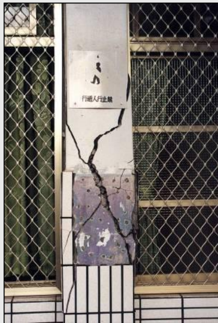
窗台柱中央剪力破壞(IV)
