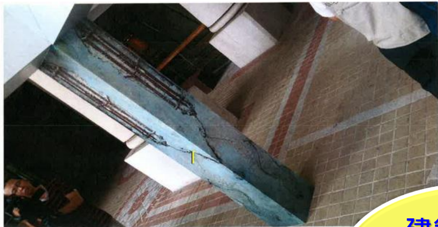
描述：柱子C4 受損情形
