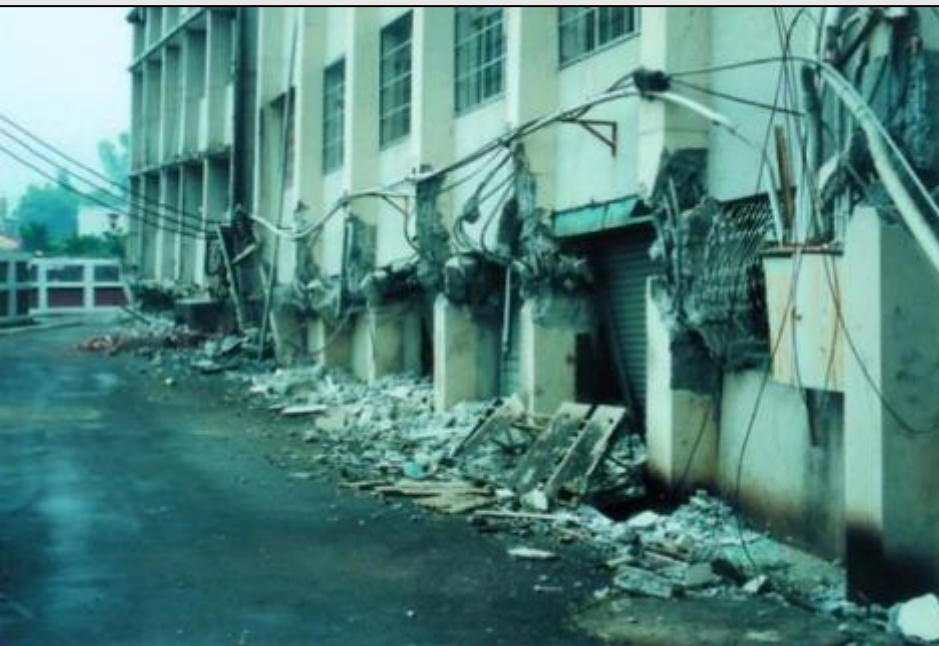
柱爆裂鋼筋挫曲，樓房崩塌
