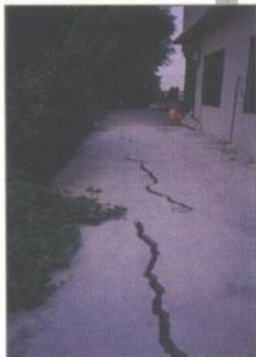
照片C-1-3 建物周圍因液化造成地坪沉 陷開裂破壞
