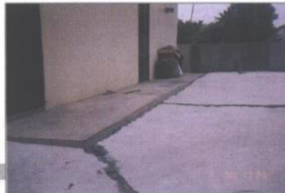
照片C-1-2 建物外緣地坪因液化導 致沉陷而與建物基礎分 離之現象
