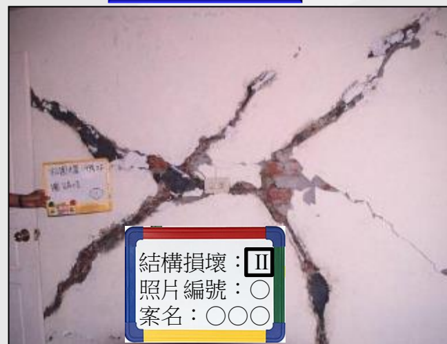
磚牆交叉裂縫
