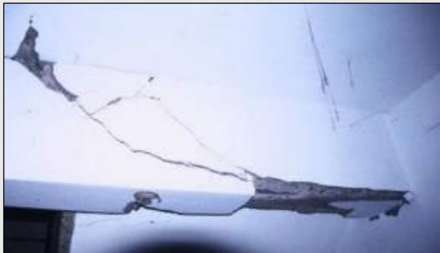
梁剪力破壞，致主筋下混凝土剝落
