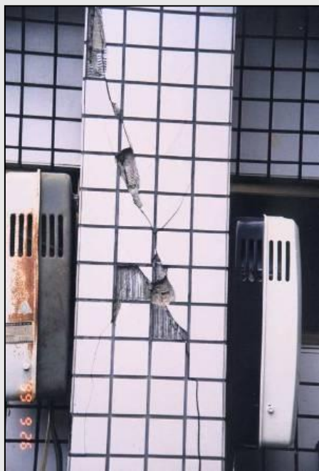
柱中央剪力裂縫(III級)
