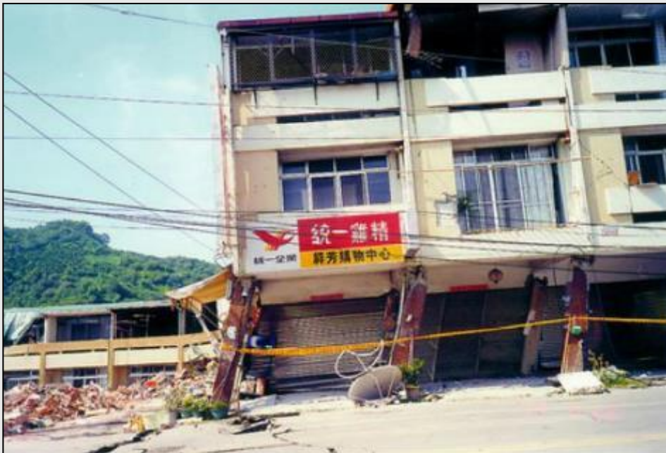
柱頂爆裂鋼筋挫曲，樓房傾斜
