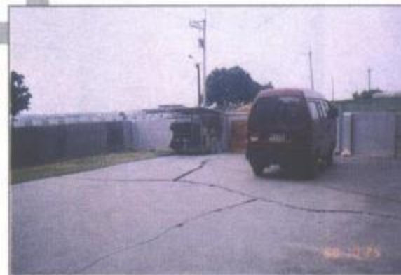
照片C-1-4 建物周圍因液化造成地坪沉 陷開裂破壞
