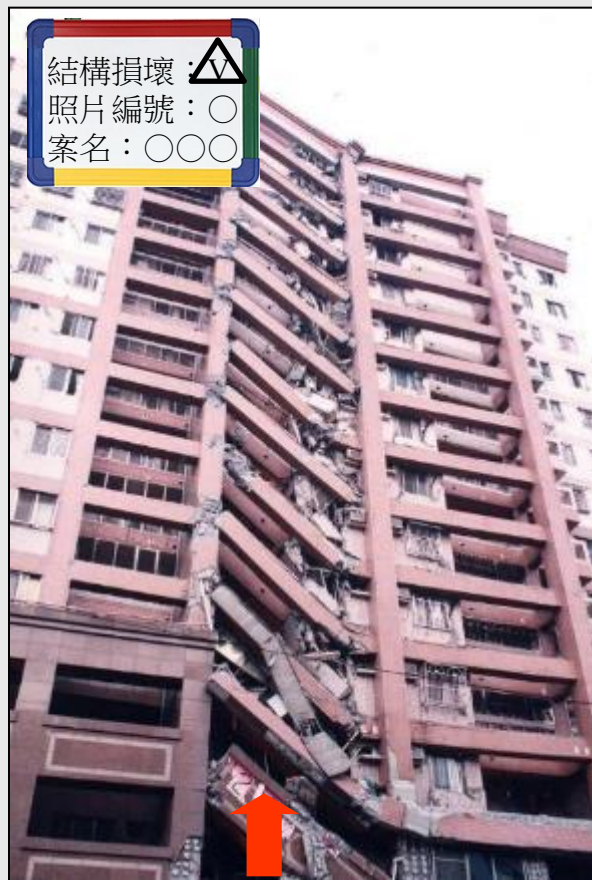
梁斷裂，鋼筋挫曲，樓層崩塌下陷
