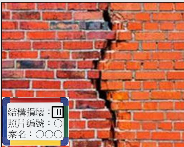
磚牆垂直裂縫(II級)
