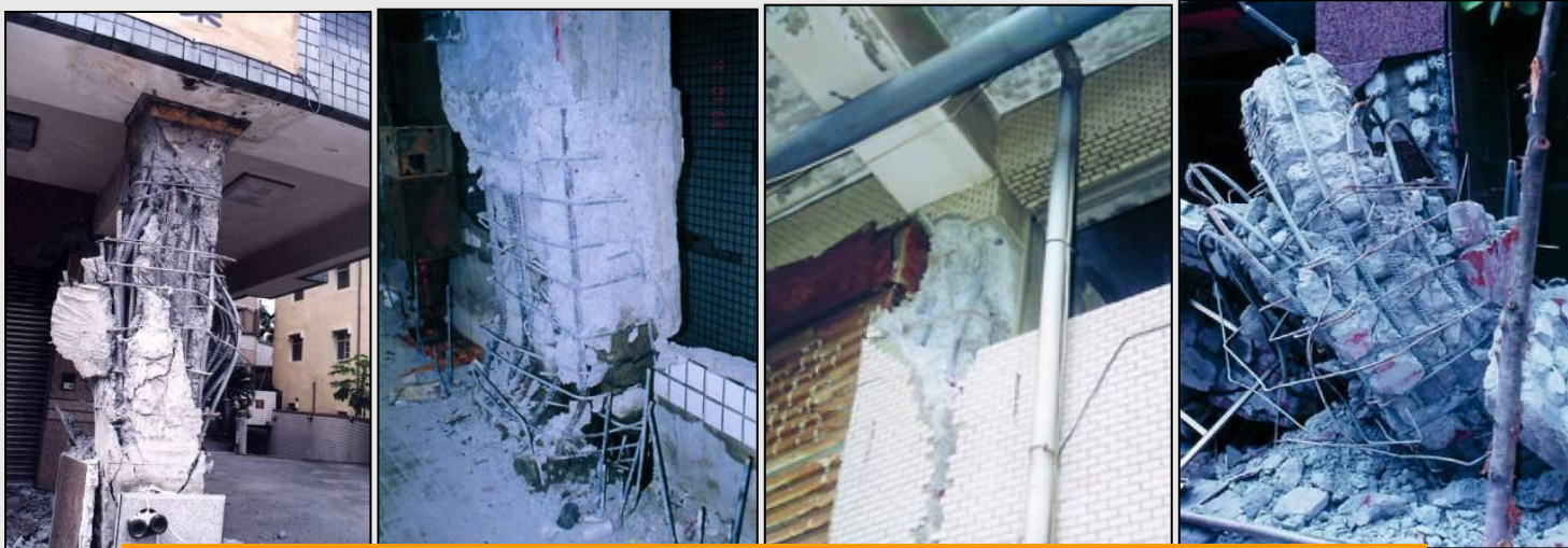
箍筋斷裂、主筋嚴重挫曲、柱心混凝土碎裂(V級)
