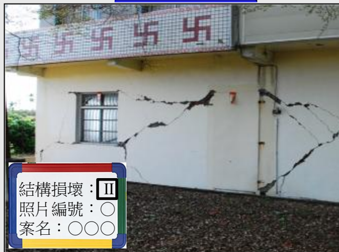
磚牆交叉裂縫
