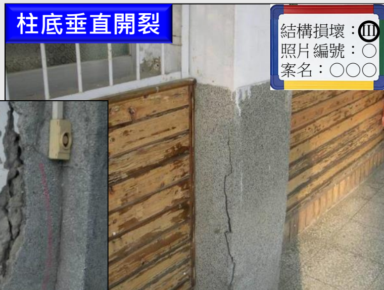
柱底垂直開裂
