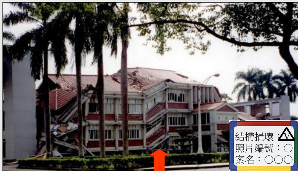
梁斷裂，鋼筋挫曲，樓層崩塌下陷
