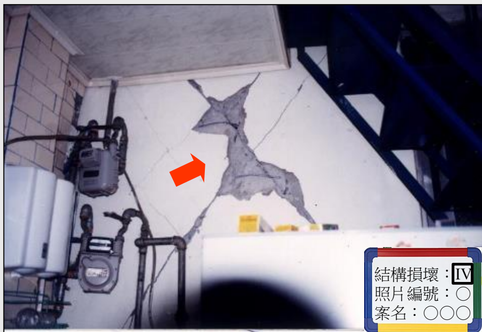
牆大量斜裂縫，混凝土剝落
