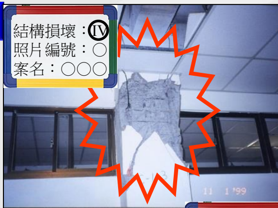
結構損壞：IV 照片編號：○ 案名：○○○
