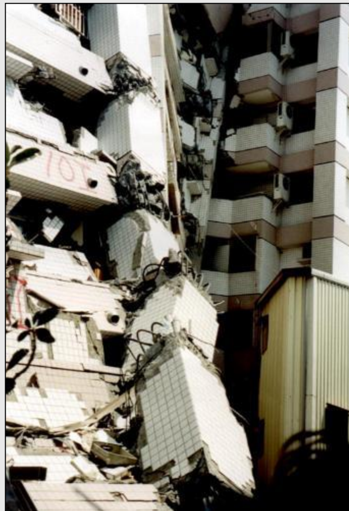
柱頭斷裂，樓房崩塌
