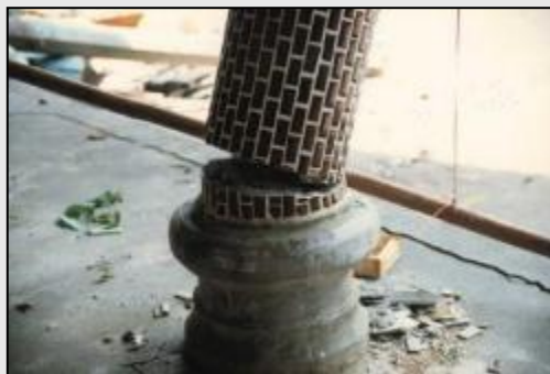
基礎與柱脫離
