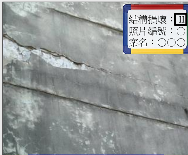
磚牆水平斷裂(II級)
