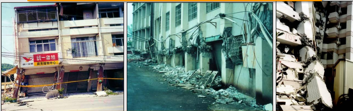
柱斷裂、柱筋嚴重挫曲，樓房傾斜、下陷
