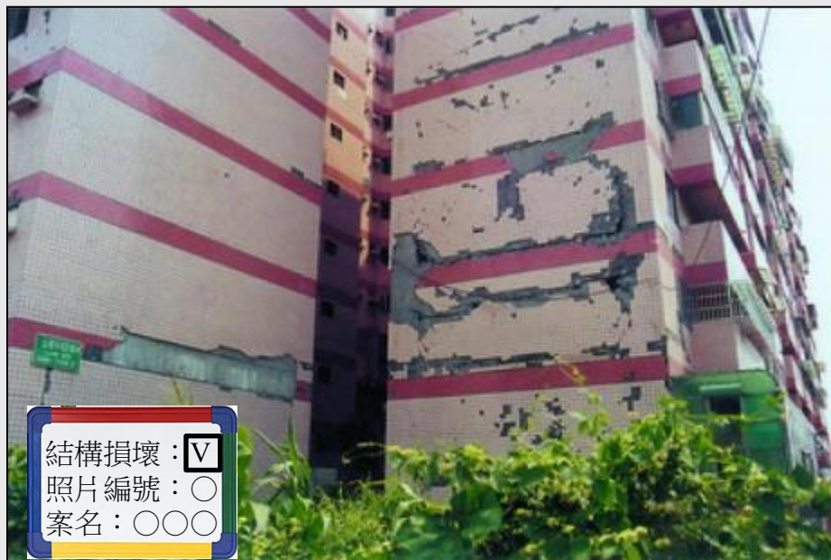
牆斜裂縫，混凝土碎裂
