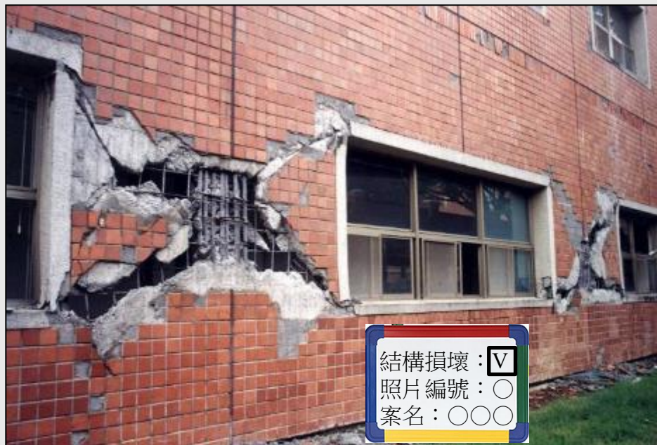
牆斜裂縫，混凝土碎裂
