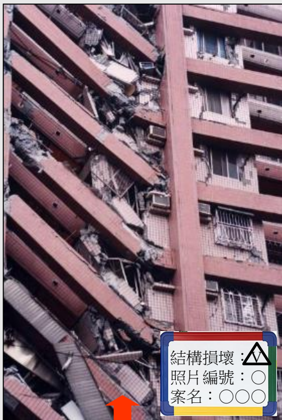
梁斷裂，鋼筋挫曲，樓層崩塌下陷
