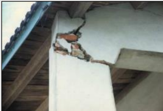
磚造建物柱頭斷裂
